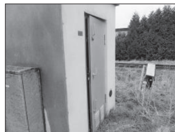
Aufgebrochenes Schalthaus an einem Bahnübergang in der Ortslage Gehofen
