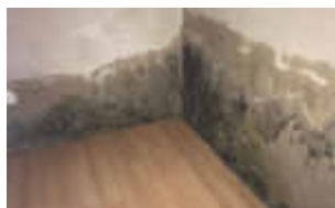
Beispielhafte defekte Horizontalsperre
